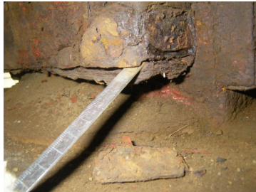
塩害地域の酷い積層錆び
