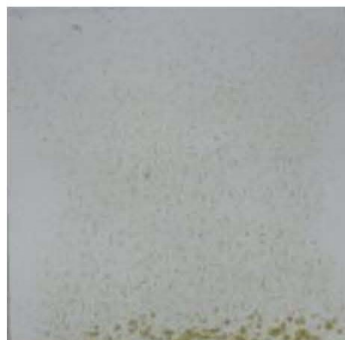
水洗浄(戻り錆び発生)
