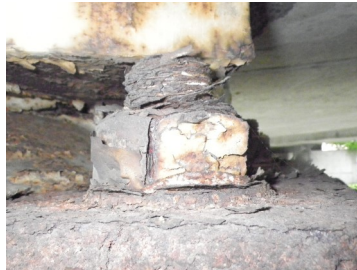
塩害により錆びに覆われた沓
