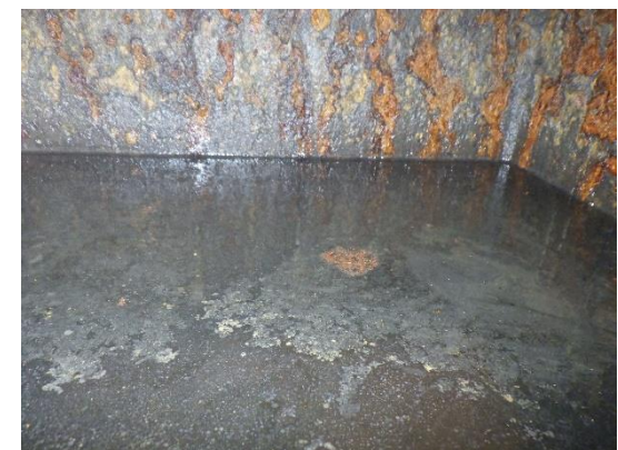
写真-15 上弦材内部滞水状況
