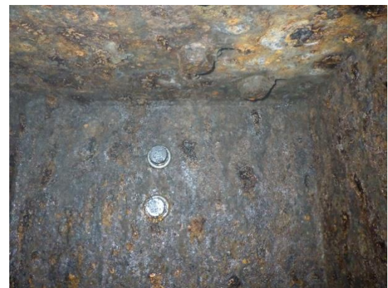
写真-14 上弦材内部腐食状況
