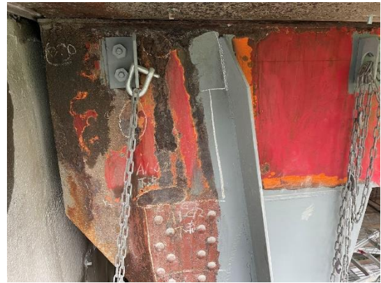
写真-13 上弦材端部腐食状況
