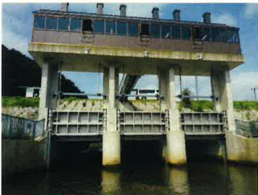
写真-3 水門（樋管）設備 （ラック式ローラーゲート）
