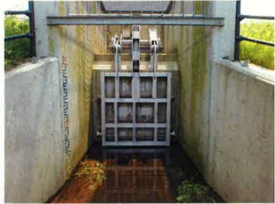
写真-4 水門（樋管）設備 （油圧リンク式ゲート）
