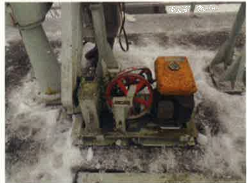
写真-11 エンジンの状態 (鋼製カバーの取外し後)
