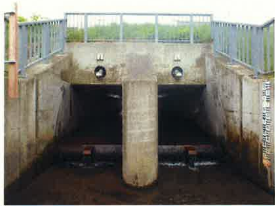
写真-5 水門（樋管）設備 （フローティング起伏ゲート）
