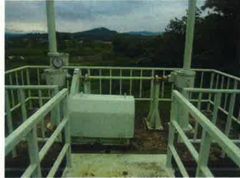
写真-9 スピンドル式開閉装置
