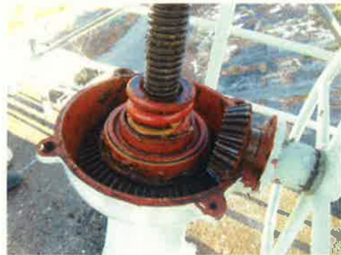
写真-7 開閉装置の分解後
