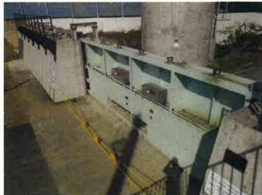
写真-6 陸閘設備 （横引き陸閘ゲート）
