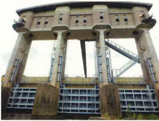
写真-2 水門（樋門）設備 （ワイヤー式ローラーゲート）
