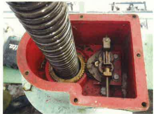
写真-10 開閉機の内部
