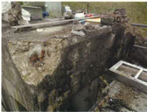
写真-13 操作台コンクリートの劣化
