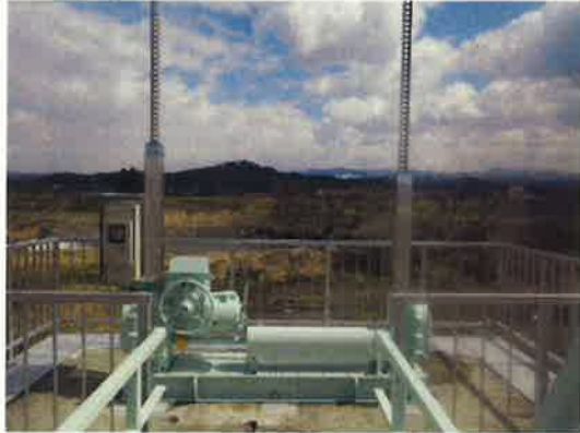
写真-12 ラック式開閉装置
